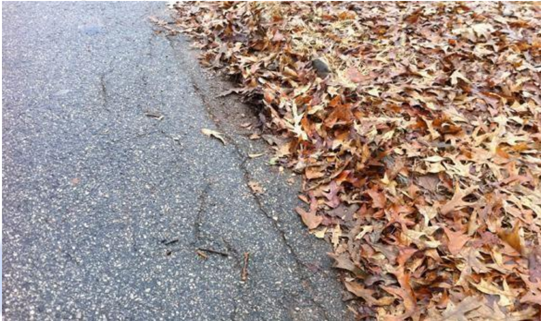
Fig. Edge Cracks
